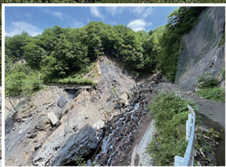
飯田市上村蛇洞沢被災地
